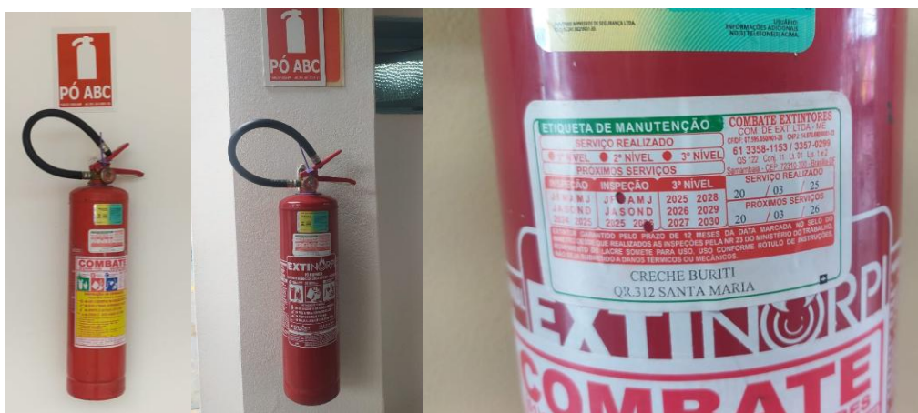
Extintores data de Validade
