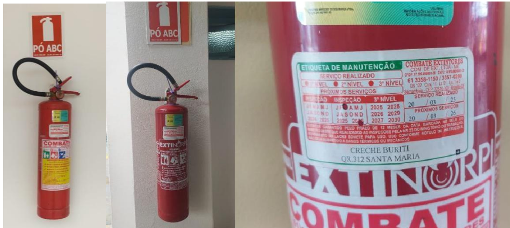
Extintores data de Validade
