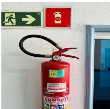
Extintor vistoriado e de fácil acesso
