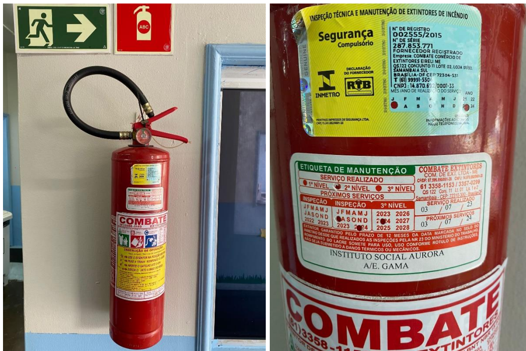
Extintores data de Validade
