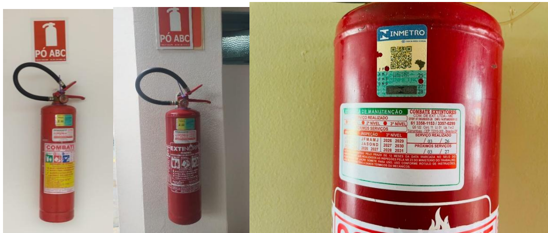
Extintores data de Validade
