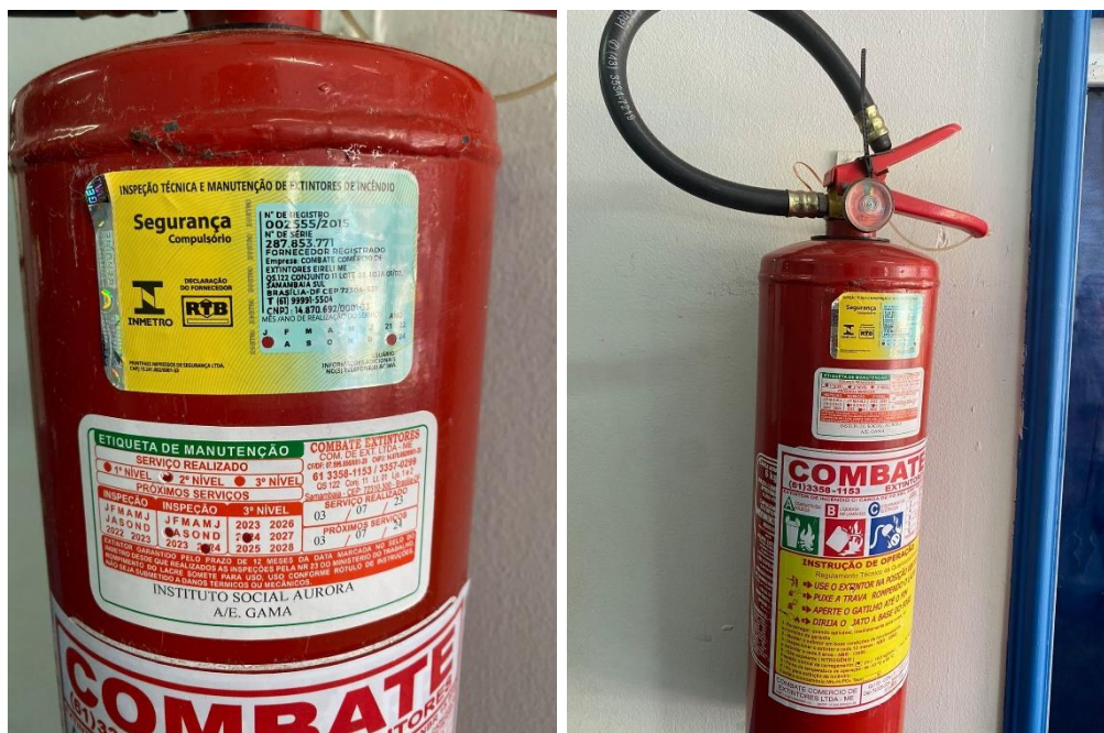
Extintores data de Validade
