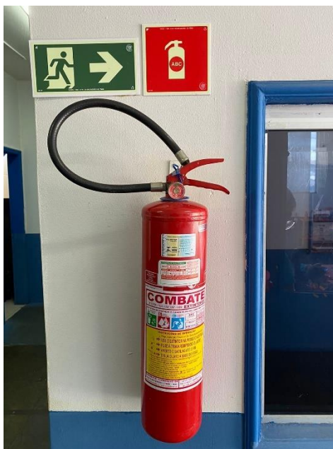
Extintores data de Validade
